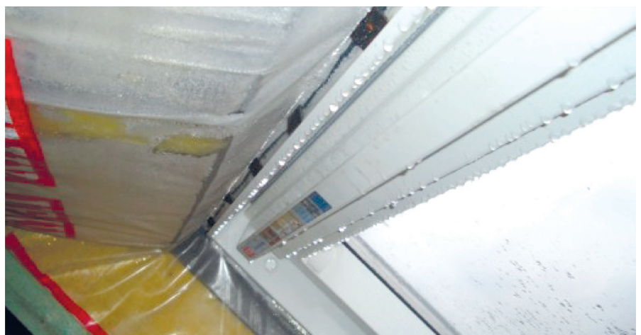
Abb. 1 – Kondensat durch Baufeuchte: Putz oder Estrichfeuchte schlägt sich auf den Bauteiloberflächen in Form von Wassertropfen nieder. Sowohl am Dachflächenfenster, als auch an der Dampfsperre kommt es zu einer massiven Kondensatbildung.
