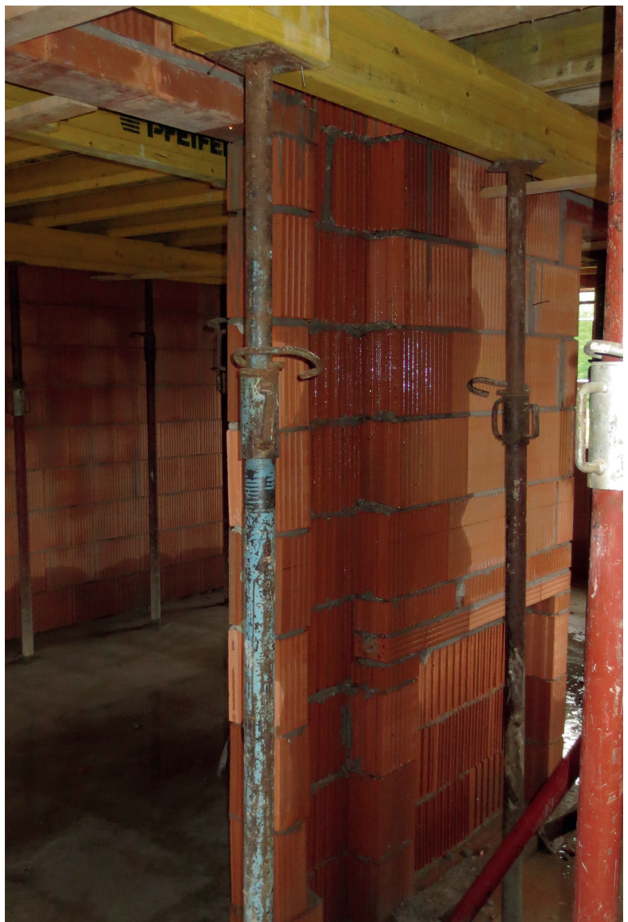
Abb. 3: Tagwasser kann in Mauerwerk zu hohen Feuchtegehalten führen. Wird diese Durchfeuchtung nicht gewissenhaft getrocknet ist Neubauschimmel kaum vermeidbar. Folgegewerke sollten ggf. Bedenken anmelden.
