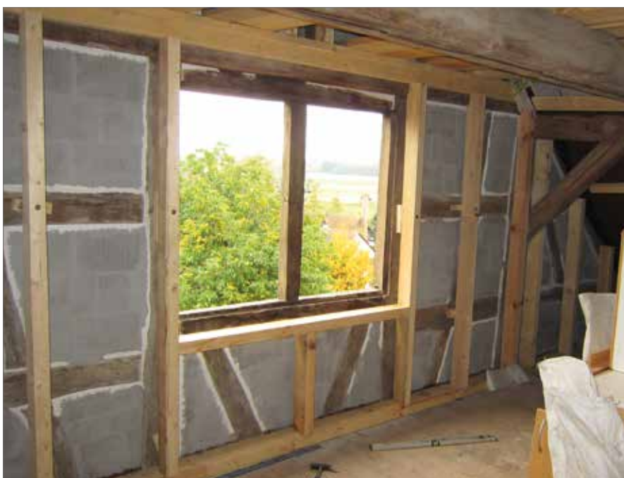
Innenputz bei Riegelwand, nachgebessert: Die Anschlussfugen zwischen Ausfachung und Riegel wurden sorgfältig nachgebessert, damit der Schlagregen nicht mehr so leicht eindringen kann
