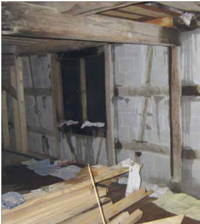
Schlagregen auf der Innenseite einer Riegelwand.
